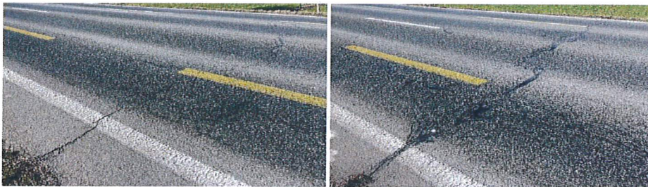
Figure 3 - Etat de la chaussée (fissuration diverse, orniérage et faïençage)
